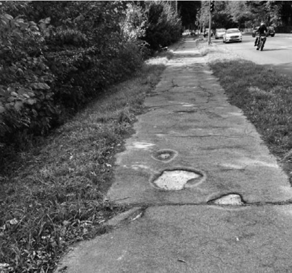
Der Rad-/Fußweg an der Opladener Straße auf Höhe der Einmündung am Wallgraben ist in besonders schlechtem Zustand.
