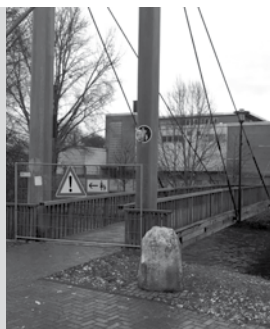
(Abb. 14) Zur Zeit gesperrt; hoffentlich bald repariert; mittelfristig dann durch einen Neubau zu ersetzen – die Henley-Brücke
