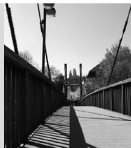
(Abb. 8) Sollte saniert werden: Die Henley-Brücke. Dies ist aufgrund des Nein zum Stadthaushalt von CDU, UWG, FDP, und BWL nun nicht möglich
